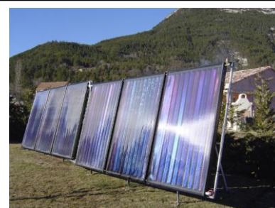
3 - Capteurs verticaux posés au sol et inclinés à 70° près d'une habitation.
