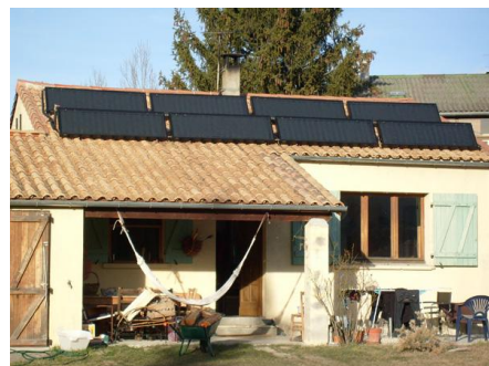
2 - Capteurs horizontaux inclinés à 60° en toiture.
