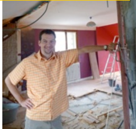
poêle de masse installé Double Flux, solaire Atmos & isolation extérieure à venir
