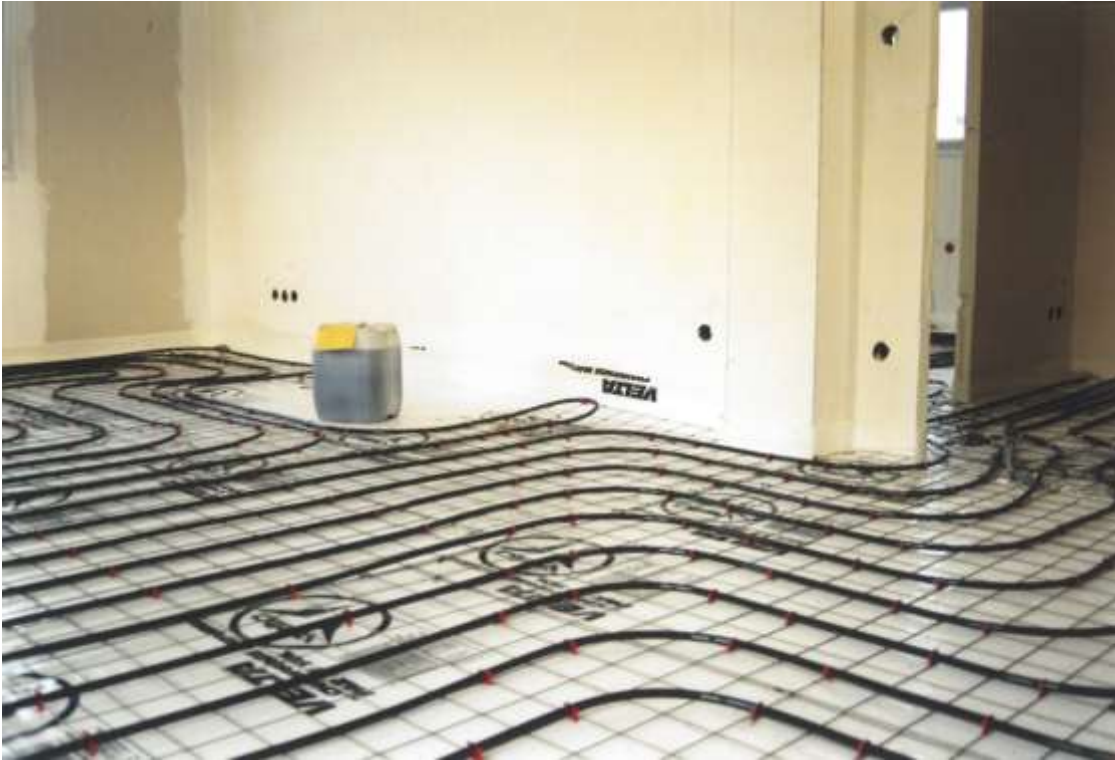
Zone séjour avec vue vers l'entrée Passage de 4 tubes au seuil de la porte pour les 2 boucles du séjour.
